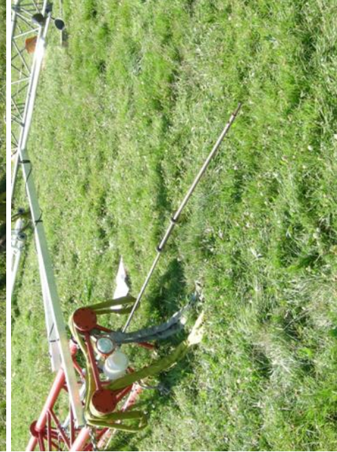
Abbildung 24: Oberster Teil vom Mast mit Feuchtigkeits- / Temperatursensor und Blitzableiter
