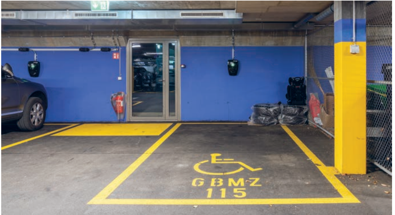
Abbildung 2: Zwei der insgesamt sechs Parkplätze, bei denen die Ladestation bereits installiert ist. Weitere 18 Parkplätze sind mit einer Zuleitung versehen worden, sodass nur noch die Ladestation angebracht werden muss, wenn Bewohnerinnen und Bewohner einen Bedarf anmelden.
