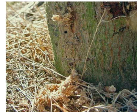
Bohrspäne unter dem Ausbohrloch
