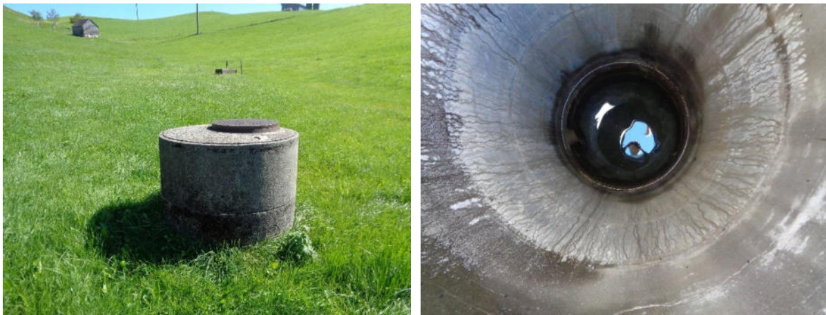
Abb. Nr. 3.3 und 3.4: Quellschacht Najenriet 4
