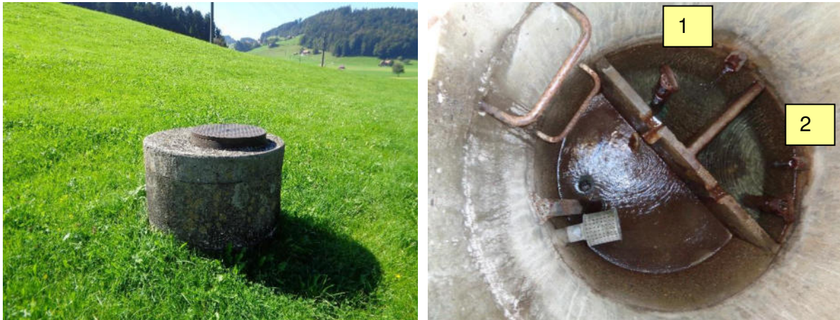
Abb. Nr. 3.1 und 3.2: Quellschacht Najenriet 1
