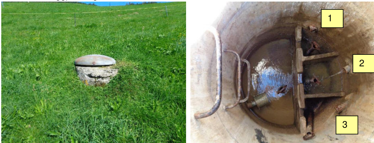
Abb. Nr. 3.5 und 3.6: Quellschacht Najenriet 33
